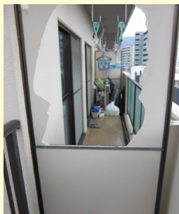
パターションの割れ
