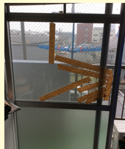
窓ガラスの割れ
