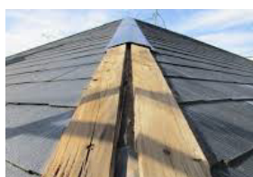
棟板金剥がれ
