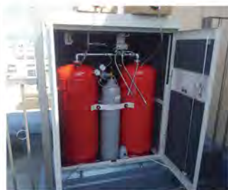
スプリンクラー設置後
